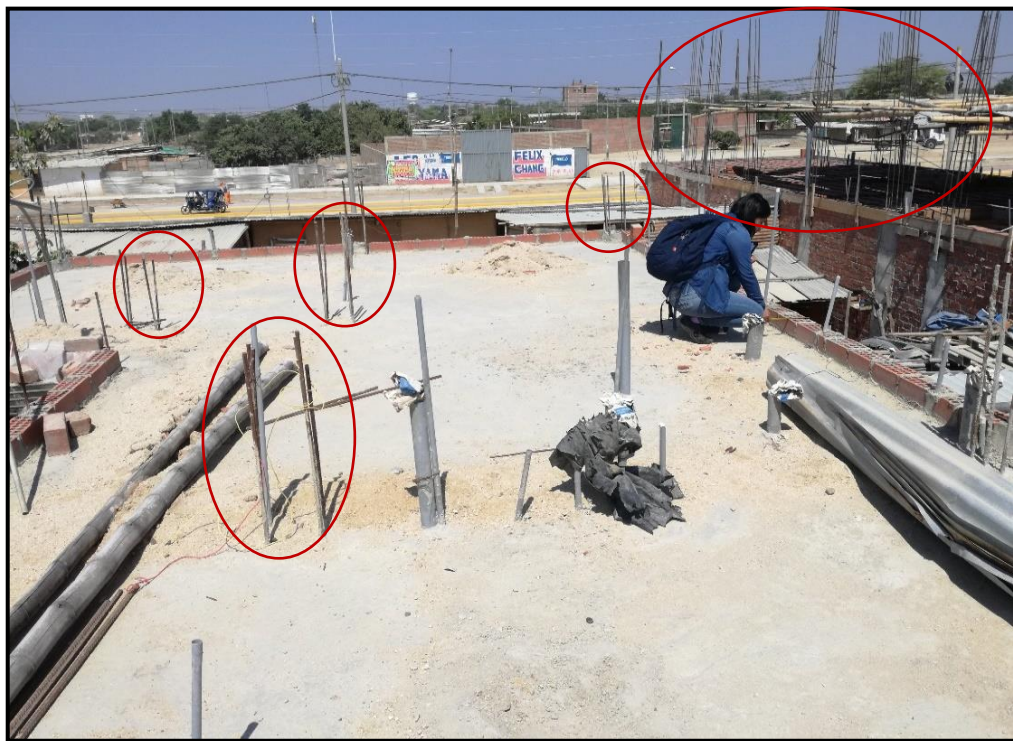
Figura 4. 8. Acero de refuerzo de columnas expuesto a la intemperie.
