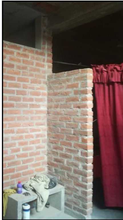
Figura 4. 2. Muro sin el arriostre adecuado.
