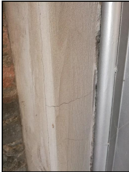
Figura 4. 3. Fisuras en columnas.
