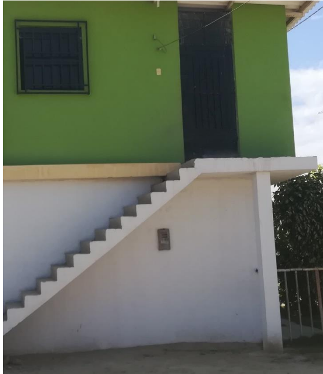
Figura 4. 9. Muros sin continuidad vertical
