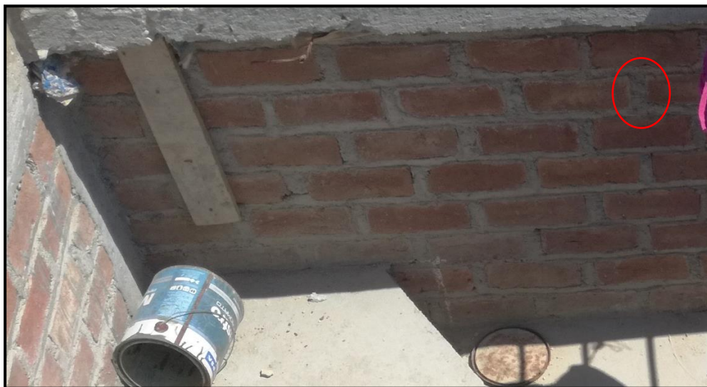
Figura 4. 7. Juntas de espesor superior al establecido en la Norma E.070
