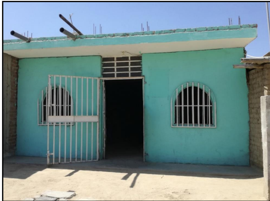
Figura 4. 1. Ausencia de junta sísmica entre viviendas
